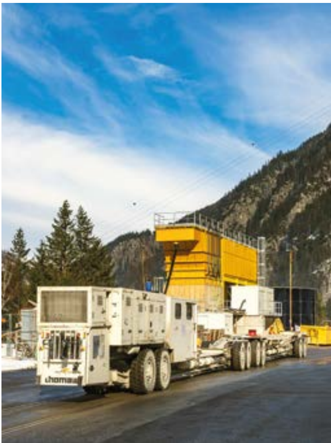
Achtachsrig und vierzig Meter lang: Das (weisse) Multi-Service-Fahrzeug erlaubt die schienenlose Versorgung der Tunnelbaustelle. Auch die Arbeiter fahren damit in den Berg.
