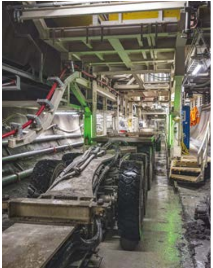
Koloss auf Schienen: In den elf «Nachläufern» der TBM sind unzählige Apparaturen und technische Einrichtungen untergebracht.
