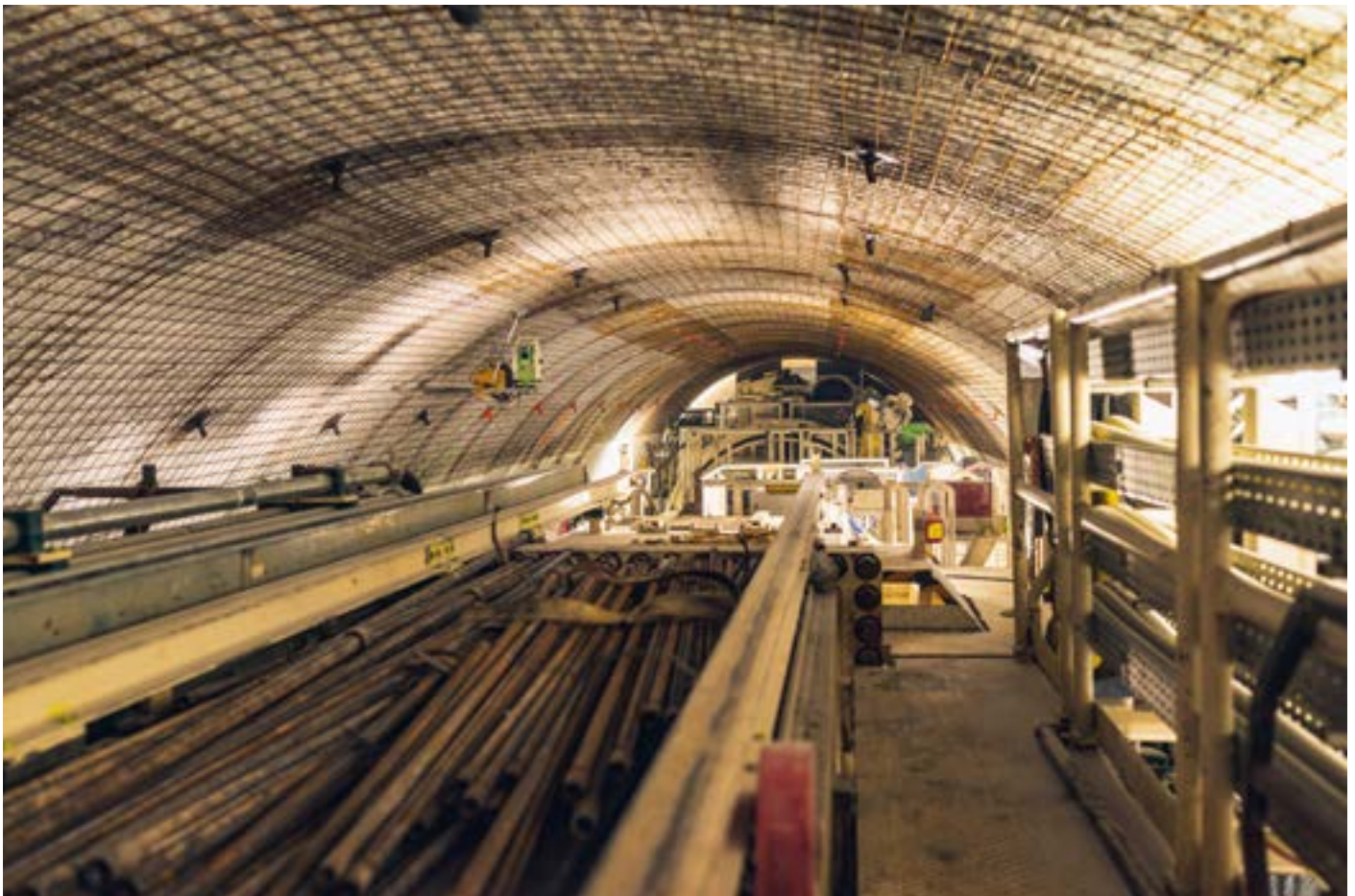
Auf dem «Dach» der TBM sichern Mineure das ausgefräste Tunnelgewölbe mit Ankern und Armierungseisen.
