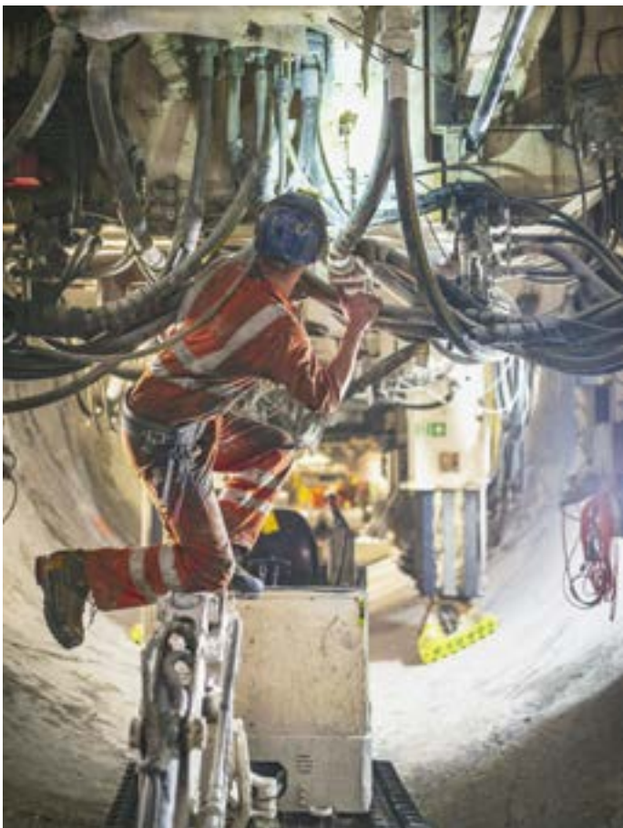
Ein gefragter Mann: Der Elektriker sorgt zusammen mit dem Mechaniker dafür, dass bei der TBM alles korrekt funktioniert.
