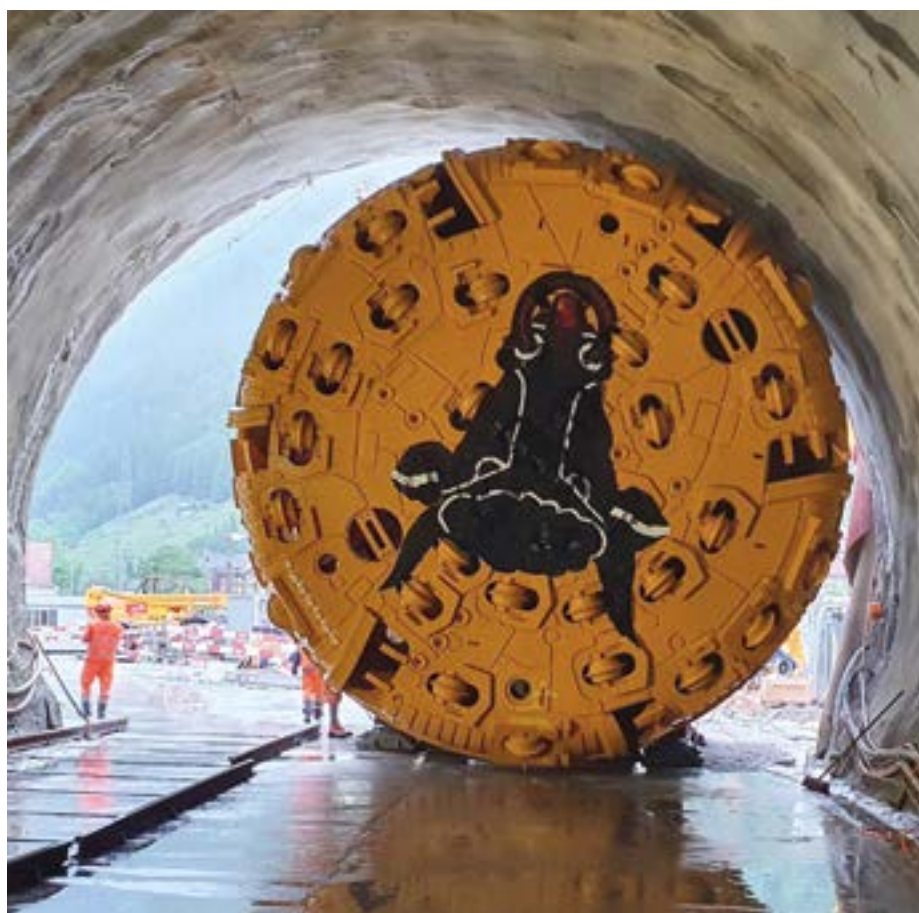
Ungetüm mit Uristier: Der Bohrkopf hat einen Durchmesser von sieben Metern und ist mit 42 Meisseln bestückt, die das Gestein zermalmen. Foto: Xavier von Mandach/Implenia
